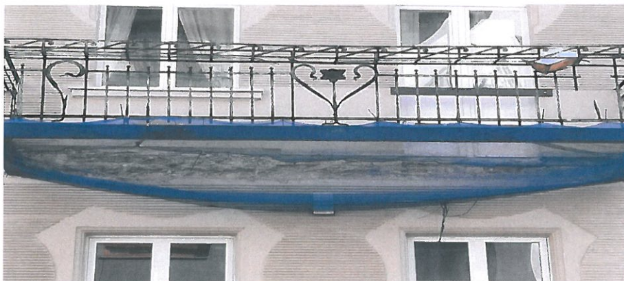
Fot. nr 2. Balkon I kondygnacji. Zwraca uwagę zabezpieczenie i brak płyty balkonowej.
