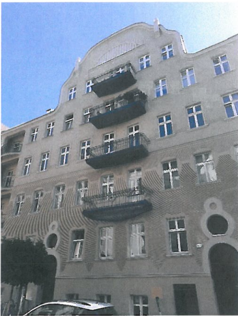
Fot. nr 1. Elewacja frontowa. Widok balkonów na ścianie frontowej przeznaczonych do demontażu. Zwraca uwagę widoczne zabezpieczenie siatką balkonu I kondygnacji.
